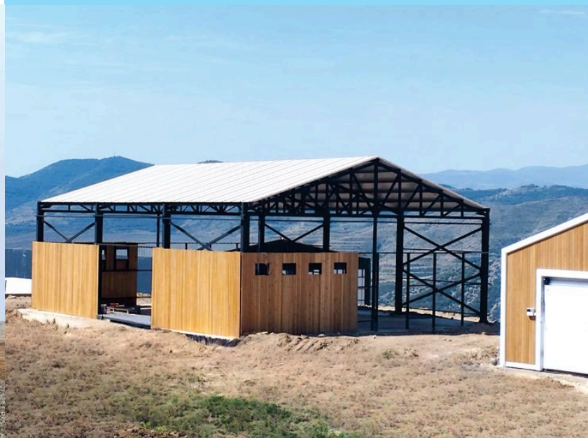
Лачин, цех сушки крови Сэндвич-панель
