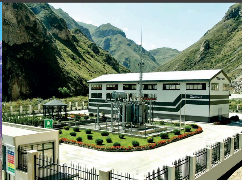
АзерЭнержи, Кельбаджар 6 ГЭС Сэндвич-панель
